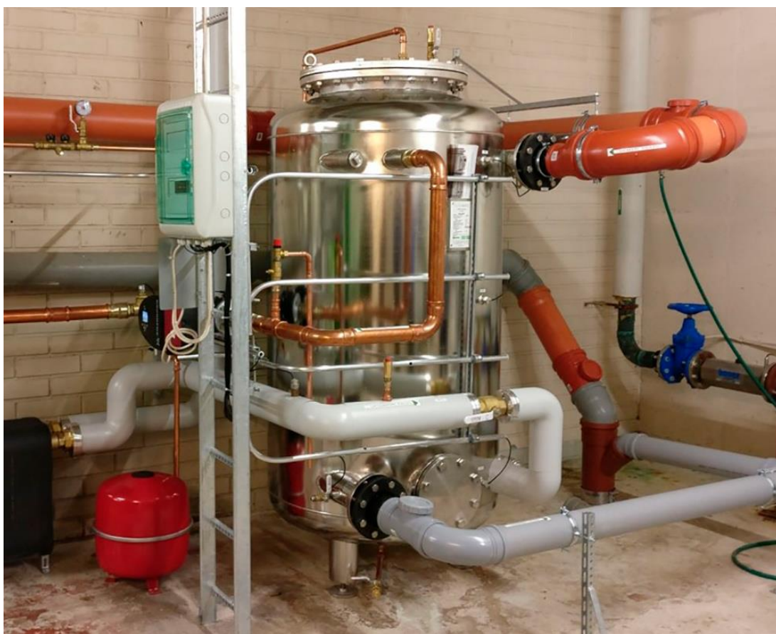
Kuva 10. Kokkolan Uintikeskus Vesiveijarin jäteveden lämmöntalteenottojärjestelmä ( https://www.ecowec.com/uimahallit-ja-kylpylat/uintikeskus-vesiveijari-kokkola/ )
