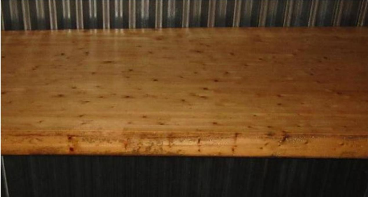
Kuva 15. Kosteus tiivistyy kattopalkin alapinnoille.
